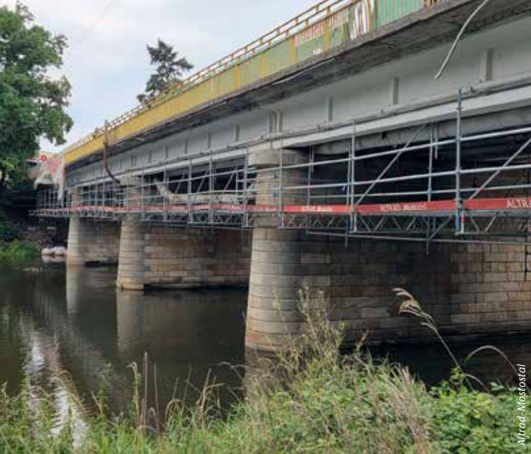
Most Żaganny w Żaganiu, znajdujący się w ciągu drogi wojewódzkiej nr 296, został uszkodzony podczas powodzi we wrześniu 2024 r.
